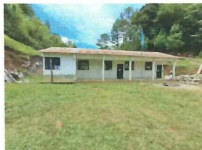
Foto 2: Necesidad de pintura en el establecimiento, esto para tener un mejor ambiente con alumnos, embellecer las instalaciones.
