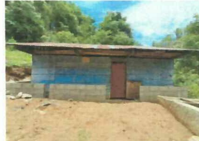
Foto 4: Cocina en mal estado, se necesita dar seguimiento para que se cuente con un lugar adecuado para la preparación de los alimentos de los alumnos, como para resguardar los alimentos semanalmente.
