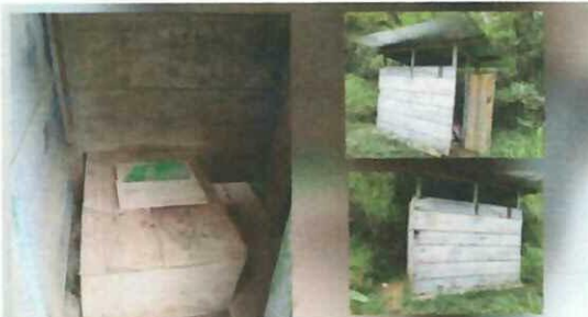
Foto 3: Instalaciones en mal estado, inadecuadas para los estudiantes. Necesidad de cambio, con la finalidad de que los alumnos tengan mejores condiciones dentro del establecimiento.
