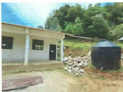
Foto 1: Canales y bajadas de agua pluvial, en mal estado, se necesita mejorar debido a que de esta forma se recolecta el agua para trabajar en el establecimiento.
